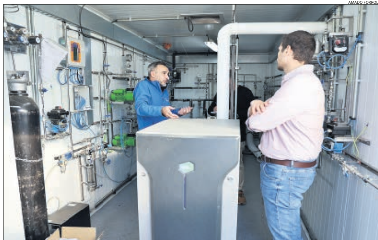
El prototip de generador d'electricitat a partir de l'hidrogen destil·lat del biogàs genera 36 kw/dia.
